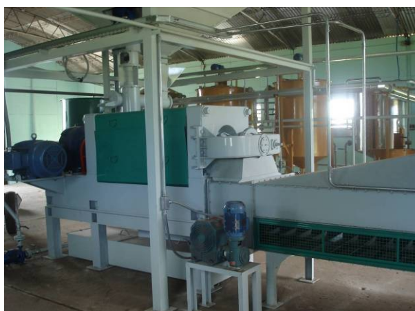
Planta de biodiesel
