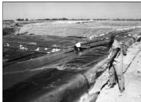
Los rellenos sanitarios de Puente Gallego I, II y III se utilizarán para extraer el biogás.
